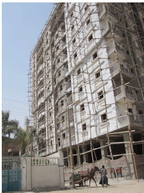
Abbildung 29: Neue Familienresidenz im Bau und unrenoviertes Haus an der Straße nach Tatoun (eigene Aufnahme, 2010)
