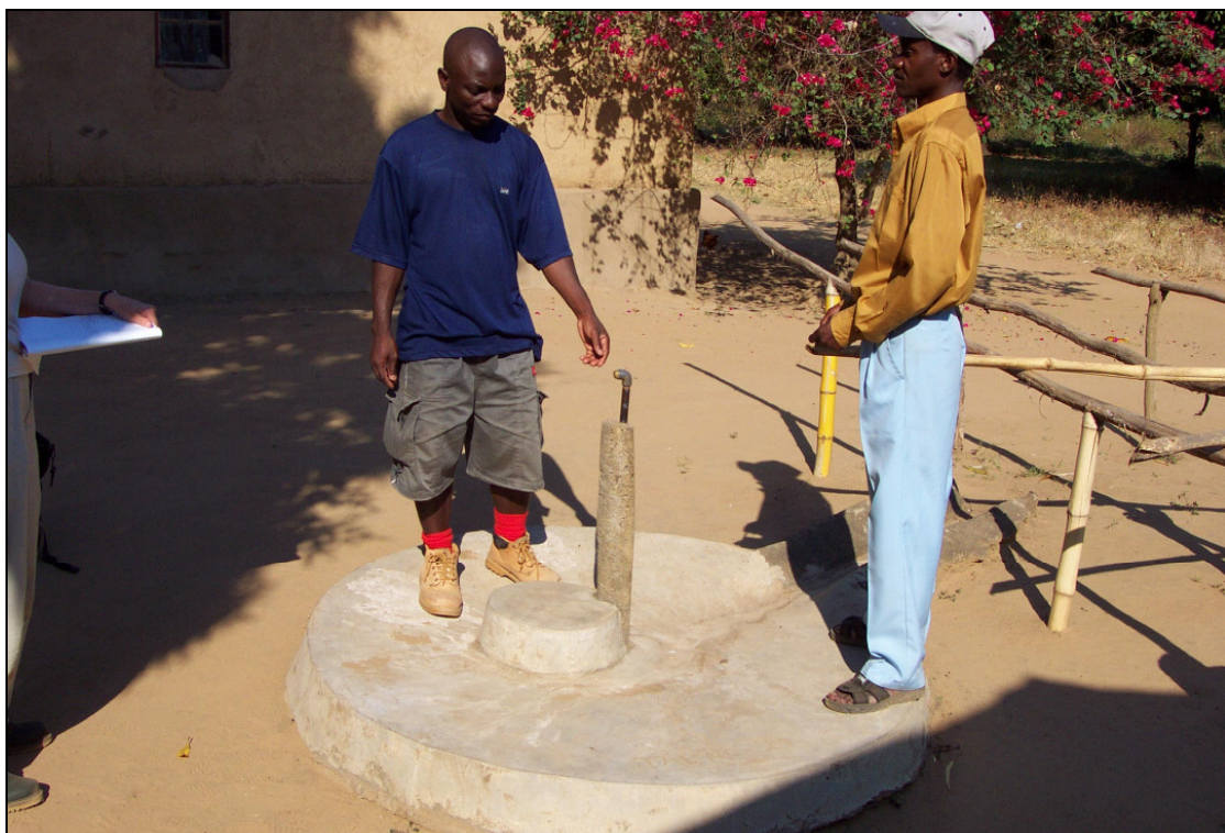
Abb. 27: Defekter Wasserhahn (Standpipe) eines Gravity Fed Water Schemes in einem Dorf (eigenes Foto)
