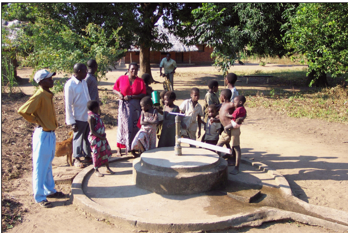
Abb. 25: Von CCAP gebauter Schachtbrunnen (Shallow Well) im Distrikt Karonga mit MARK V Pumpe (eigenes Foto)
